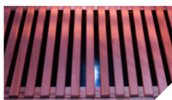
Panel de carbono en el suelo
