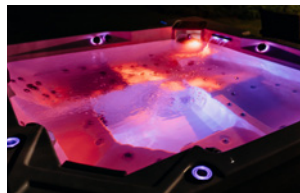
Iluminación LED Pila
